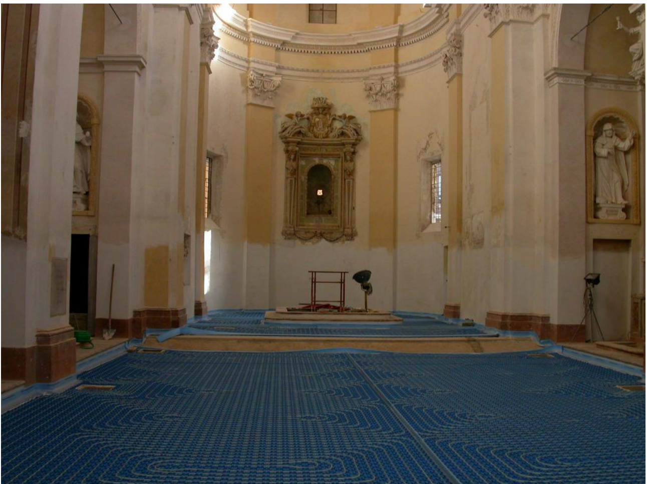
Chiesa dei Servi -Novellara (RE) - Impianto Termico realizzato
