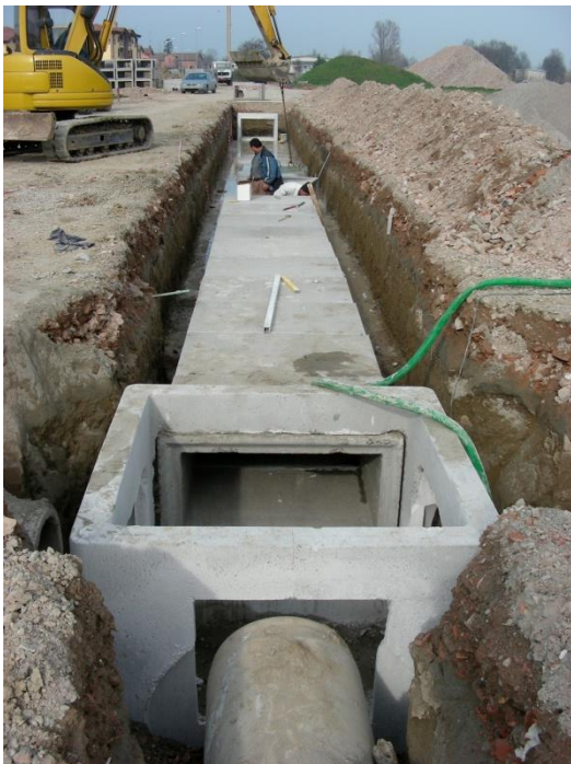
Urbanizzazione residenziale NU2a – Campagnola Emilia (RE) – Posa in opera condotta scatolare in CA.
